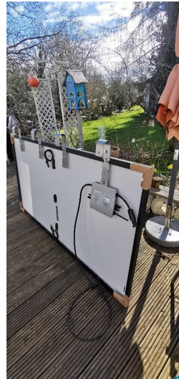
Abbildung 12: Wechselrichter am äusseren Geländerhaken
