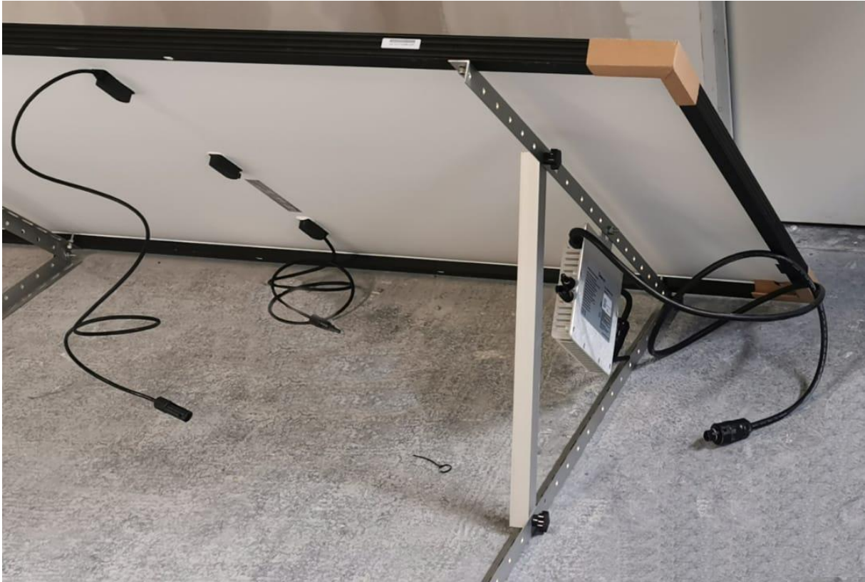
Abbildung 16: Fertig montierte Aufständerung mit angehängtem Wechselrichter
