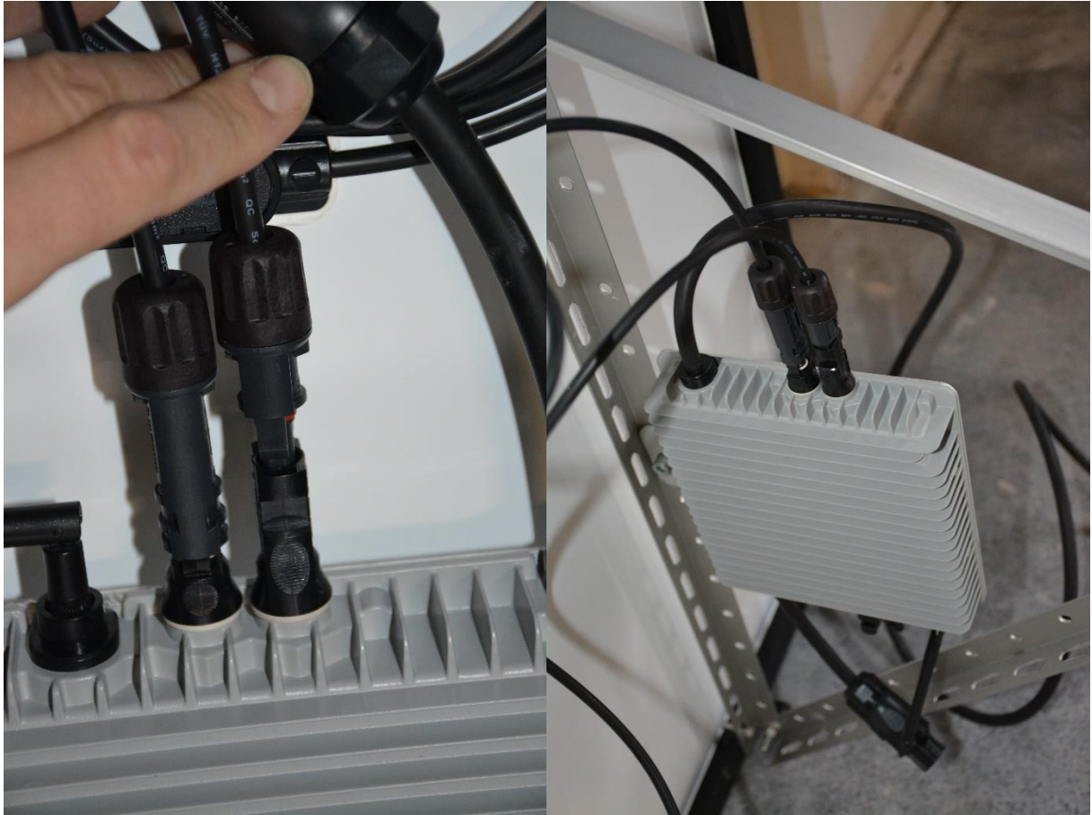
Abbildung 17: Verbindung der Gleichstromkabel mit dem Wechselrichter
